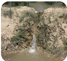
Sistema de drenagem representando risco para entrada do caracol
